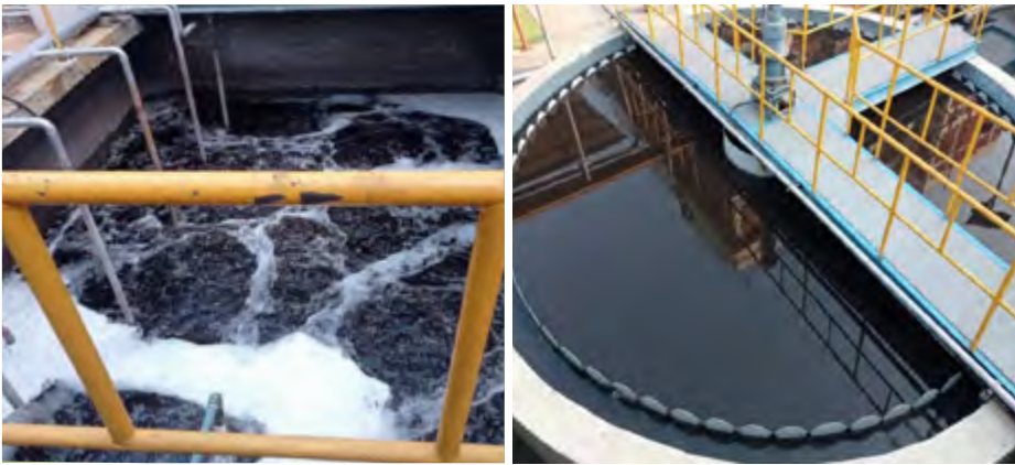
방글라데시 DEPZ 내 ETP 수처리 설비
